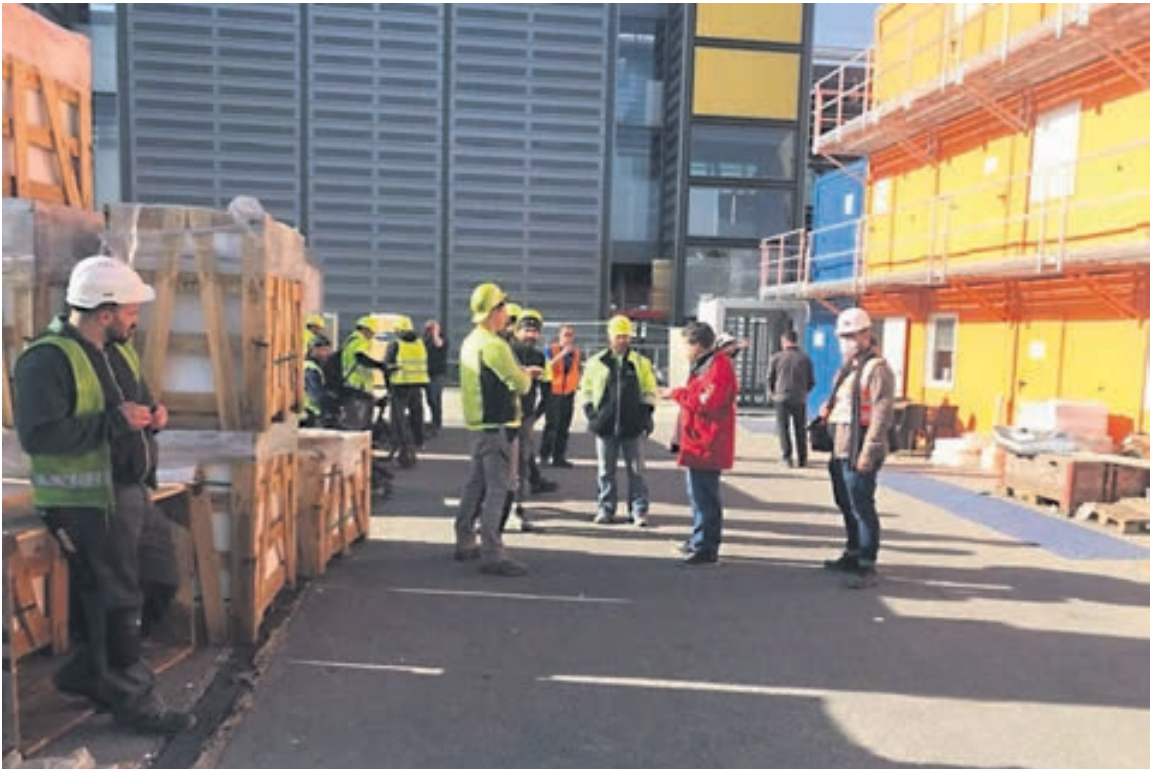
Les syndicalistes d'Unia se sont rendus sur le chantier de l'aéroport de Cointrin à plusieurs reprises pour soutenir les ouvriers et ont constaté le non-respect des mesures d'hygiène. Parmi les travailleurs, cinq étaient suspectés d'être contaminés par le virus.
