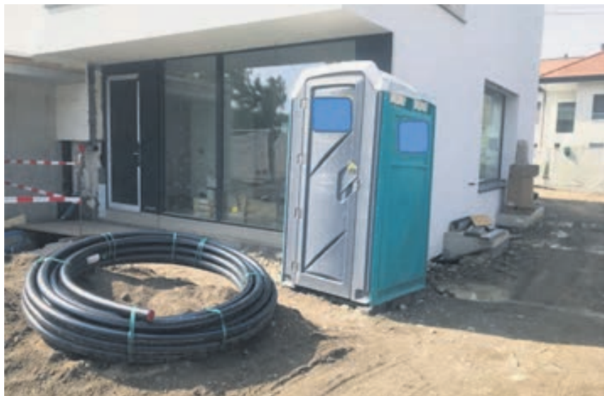
Cet été, le nombre de toilettes chimiques non réglementaires a proliféré sur les chantiers genevois, entraînant des conditions insalubres et à la limite du supportable pour les ouvriers.
