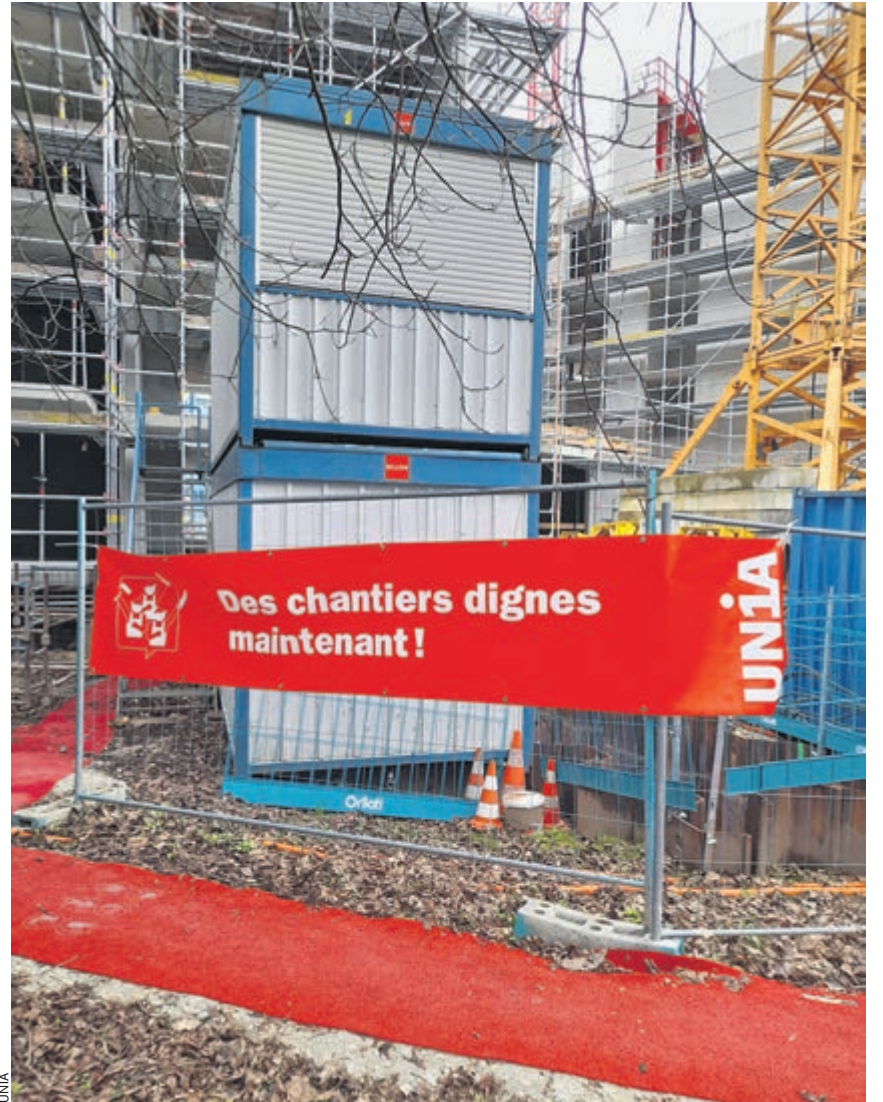
Unia se bat pour que les ouvriers de la construction soient protégés des risques de contracter le virus. Ce foyer de contamination découvert sur le chantier des Allières aux Eaux-Vives est le plus important depuis le début de la pandémie.
